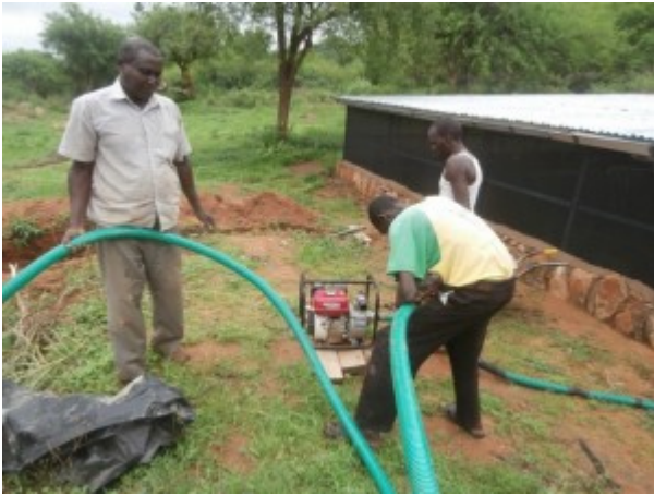
19-collegamento alla pompa
