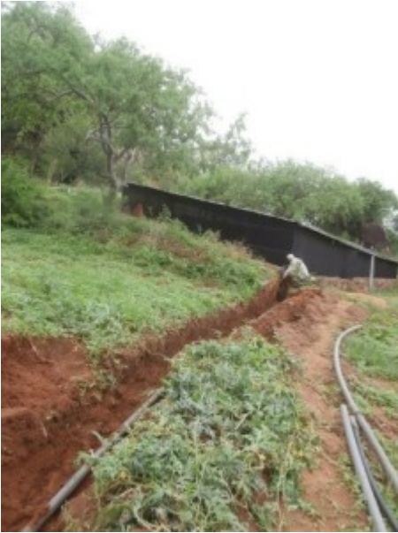
16-collegamento tra i due bacini di raccolta per i necessari travasi
